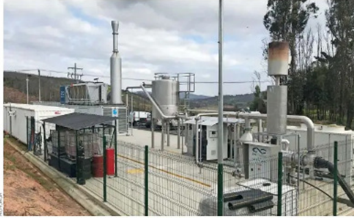
Planta de biogás en el relleno sanitario de Hidronor en la comuna de Florida, cerca de Concepción.
